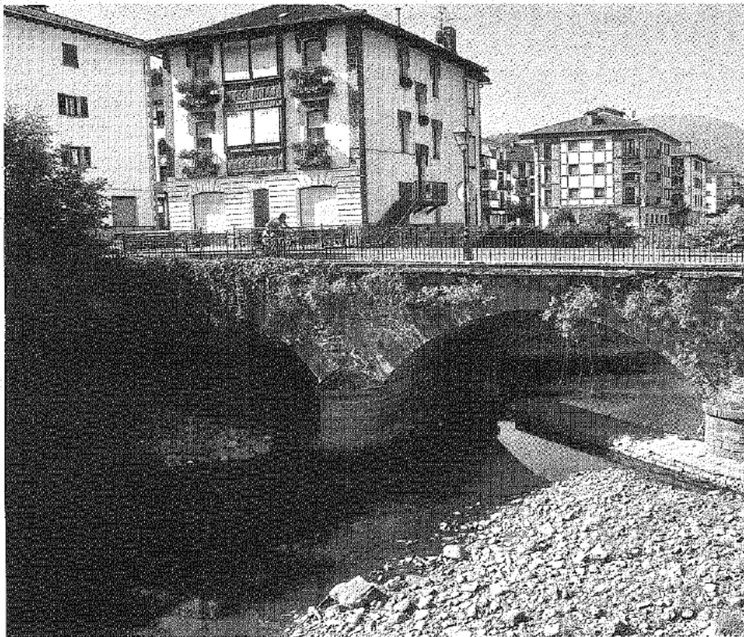
La antigua presa de Opoka, en Elizondo, donde la acumulación de piedras y la falta de dragado han arruinado
