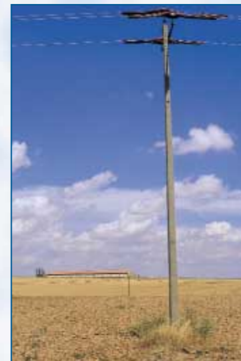
Fundas protectoras en un apoyo de anclaje con aislador rígido, con los cables a la misma altura del travesaño, en el tendido de Campo de San Pedro.
