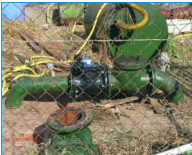
Figura 3.7. Conservación deficiente de una instalación
