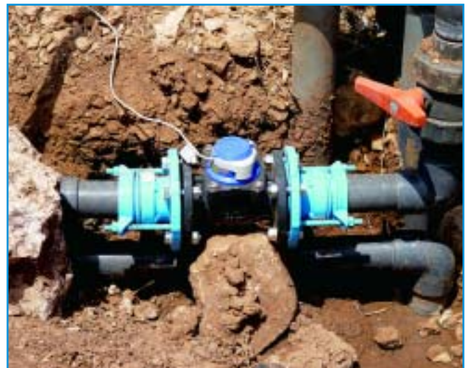
Figura 5.4. Contador de agua conectado al radiotransmisor
