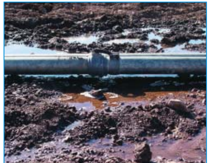
Figura 3.6. Fuga de agua en acople
