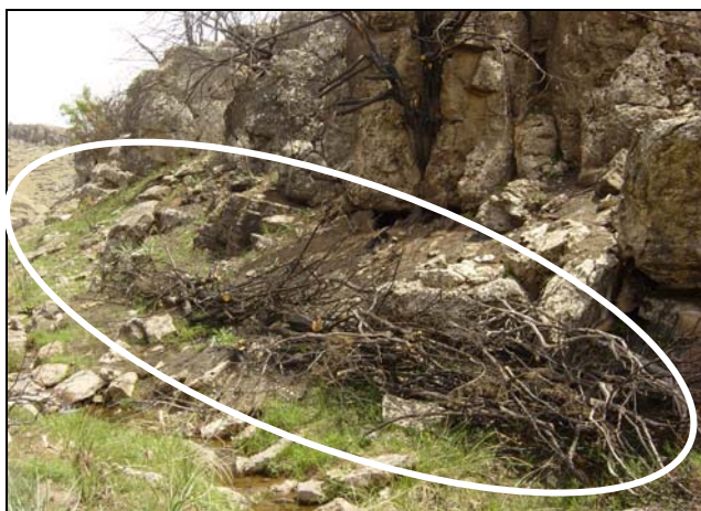
Incorrecta construcción de fajinas paralelas a un curso de agua.
