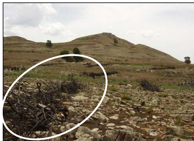
Incorrecta construcción de fajinas, tanto en diseño como en ubicación (zona rocosa llana).
