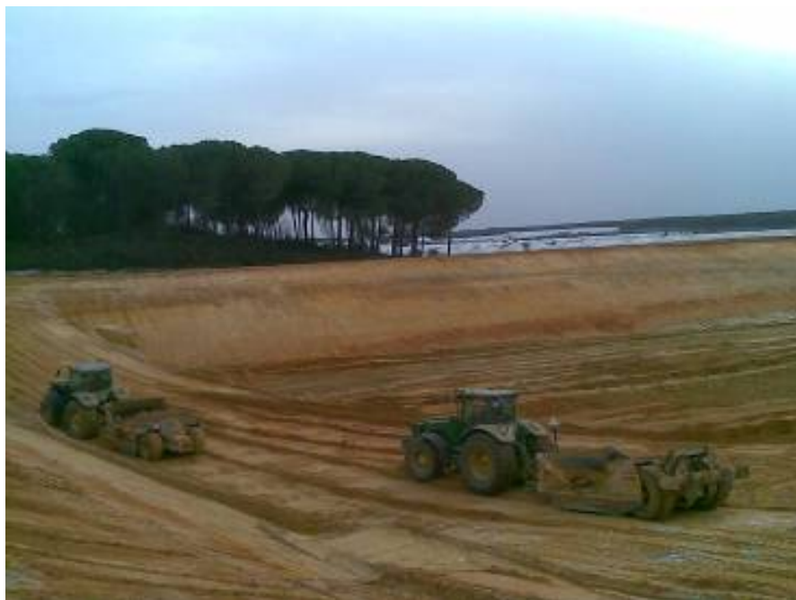
Construcción de una balsa de riego en la zona fresera, que WWF denunció por falta de permisos
