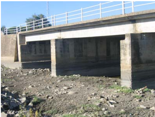
Estado del arroyo de la Rocina a su paso por el Puente de la Canaleja, Otoño de 2005
